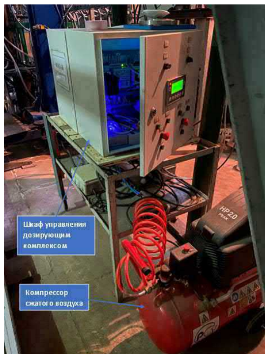
Рис. 4. Модернизированная установка ИПХТ. Шкаф управления
